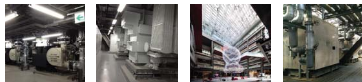
高効率ターボ冷凍機 (南館、北館 地階)
