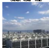
冷却塔 (タワーA、B、C 屋上)
