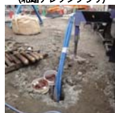
地中熱交換ポアホール (うめきた広場)
